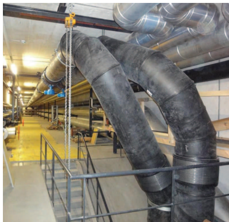
Rohrleitungen für Wärme und Kälte
